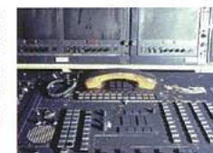
火災にあった配電盤
